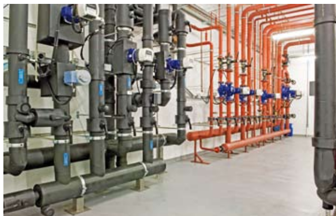
Rohrnetzverteilung Kälte- und Wärmeträger
