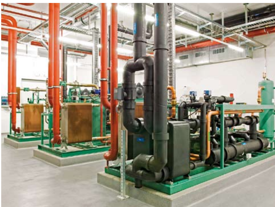
Verbundanlage mit Glykol Kälteträger
