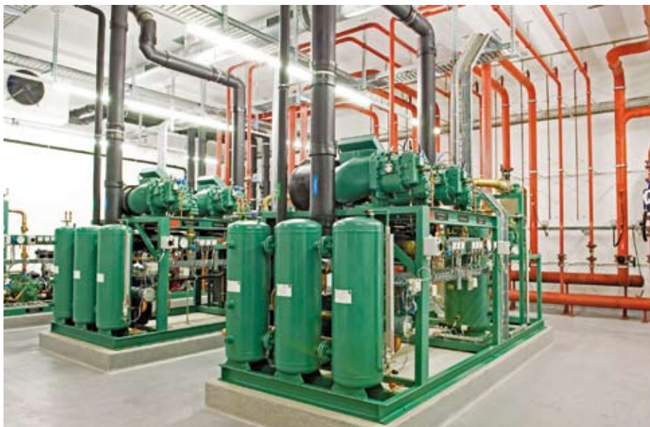
Maschinenraum mit friosol-Verbundanlagen
