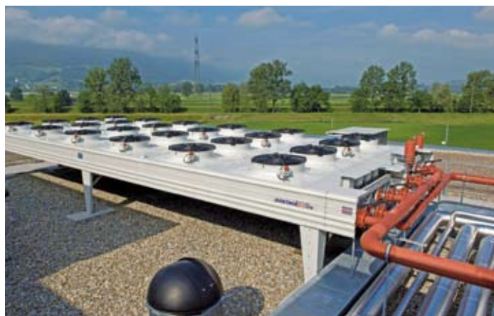
Glykol Rückkühler 2 x 545 kW
