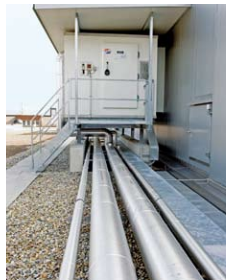
Leitungsführung zu den Isolierkühlern
