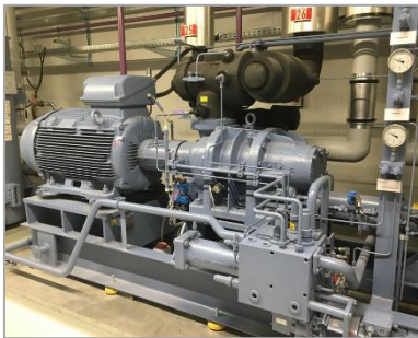
Neuer Schraubenverdichter zur Verstärkung der NH 3 -Kälteerzeugung
