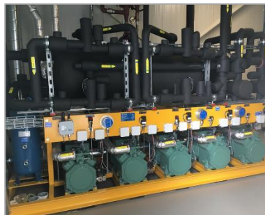
Verbundanlage der CO 2 -Kälteerzeugung für die Kühlräume
