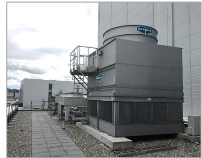
Aussenbereich – Verdunstungs- und Trockenverflüssiger Ammoniak
