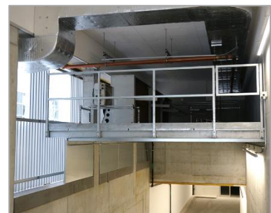
Architektur und Technik vereint, Gaskühler CO 2 für Wärmeabfuhr
