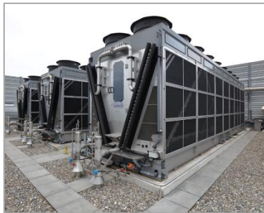
Luftgekühlte NH 3 Hybridverflüssiger Dach
