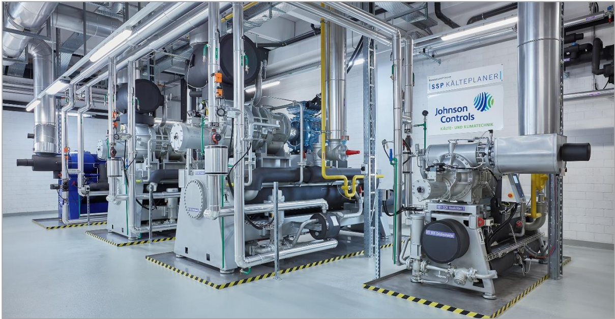
Blick in die neue Kältezentrale Schraubenverdichter -38°C
