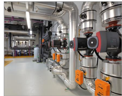
Pumpenverteilung Abwärmenutzung und Glykol
