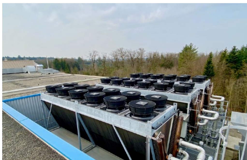
Hybridrückkühler anstelle der zurückgebauten Ammoniak-Verflüssiger.
