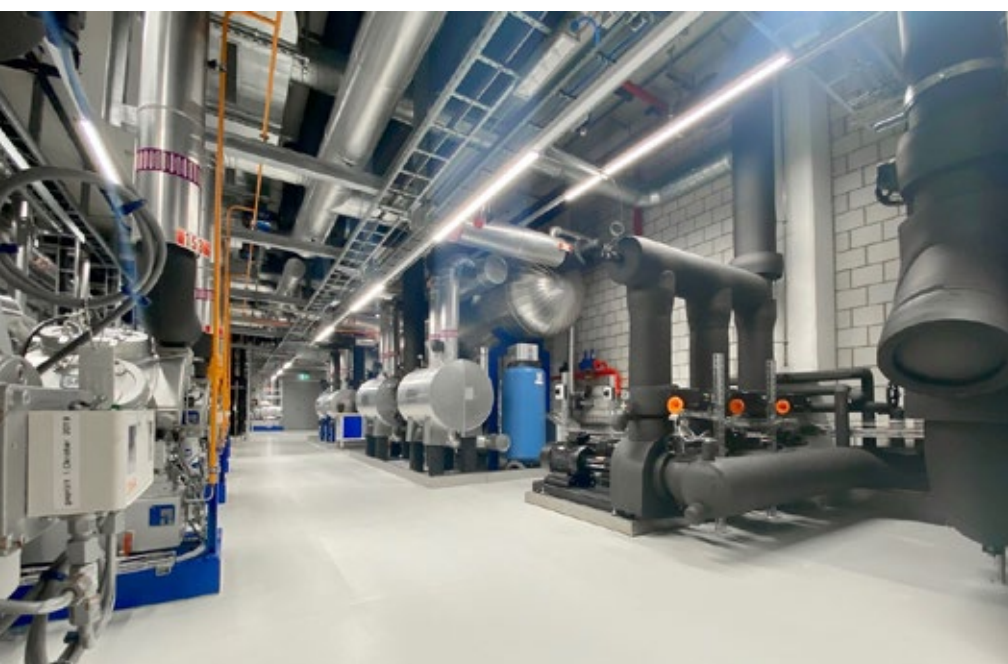
Emmis neue Kältezentrale mit Kälte-trägerkühlung.
